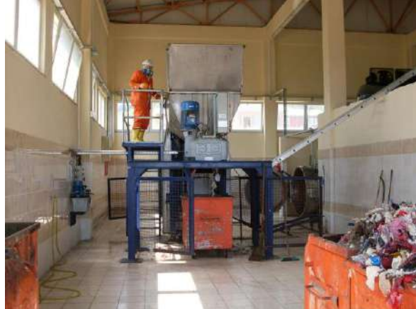
Resim: Tıbbi Atık Sterilizasyon Tesisi Binası, Sterilizasyon Ünitesi, Parçalama Ünitesi
