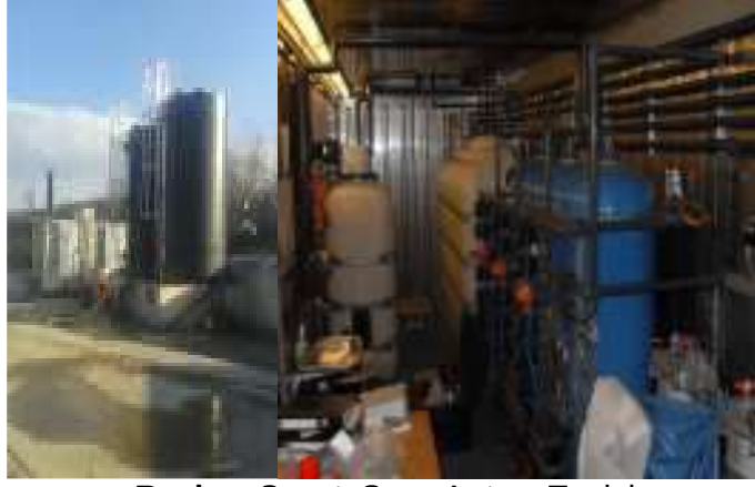
Resim : Sızıntı Suyu Arıtma Tesisi
