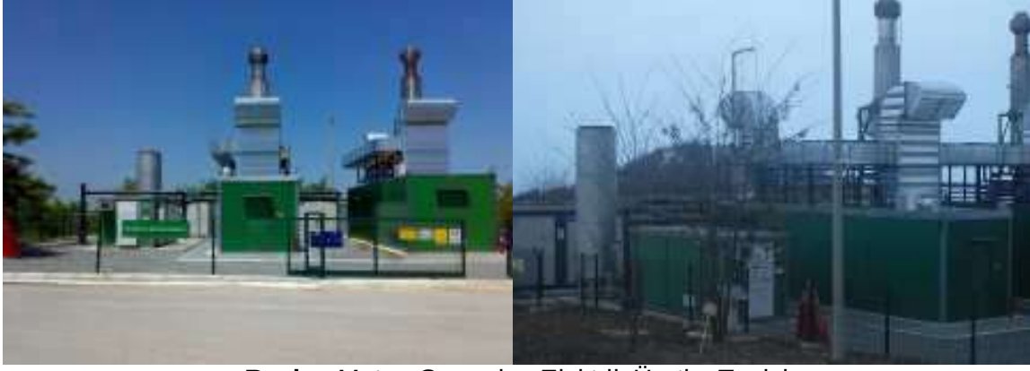
Resim: Metan Gazından Elektrik Üretim Tesisi
