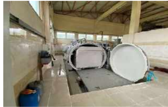
[ Tıbbi Atık Sterilizasyon Tesisi ]
