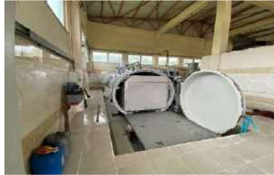
[ Tıbbi Atık Sterilizasyon Tesisi ]
