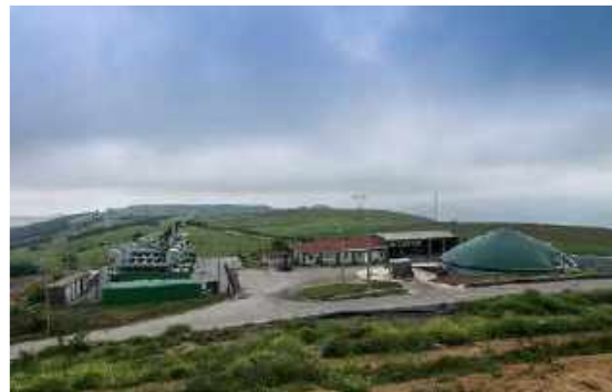
[ Metan Gazından Elektrik Üretim ve Biyogaz Tesisi ]
